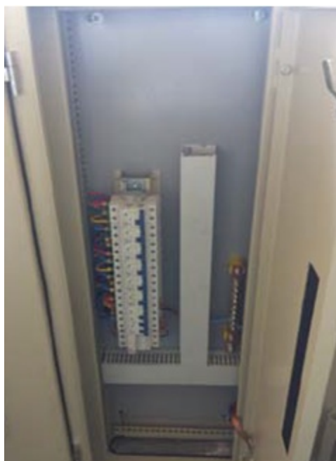
شکل (7): نمایی از بخش خروجی تابلو
